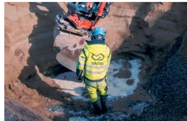
Vatten och avlopp
